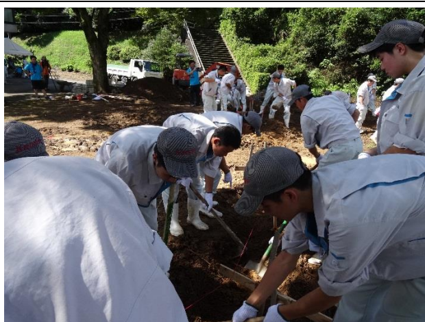
基礎を設置するため皆で土掘り。 汗だくで頑張っています。
