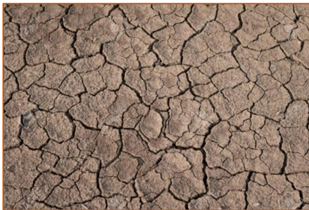
写真3（地面のひび割れ）
